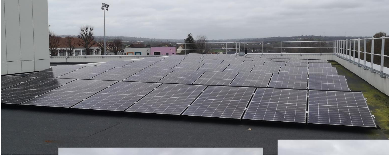
Panneaux Photovoltaïques Gymnase de Condé sur Vire
