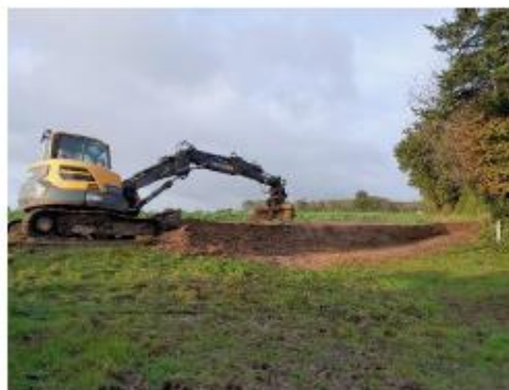
Création de talus préalable à une plantation, La Coudraie basse à Saint-Amand
